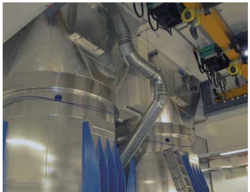
Entrauchungsventilatoren BHF Löwengasse mit je 209 m 3 /s Leistung
