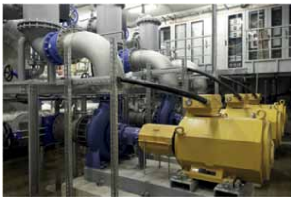
Stazione delle pompe
